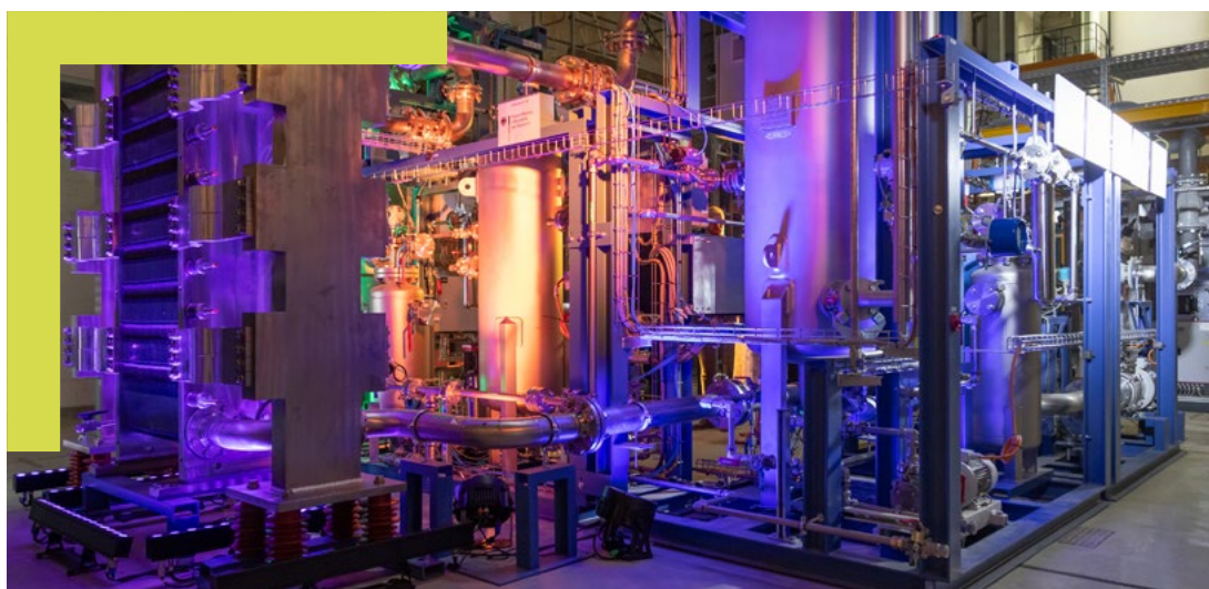
Teststand für Elektrolyseur zur Produktion von Grünem Wasserstoff
